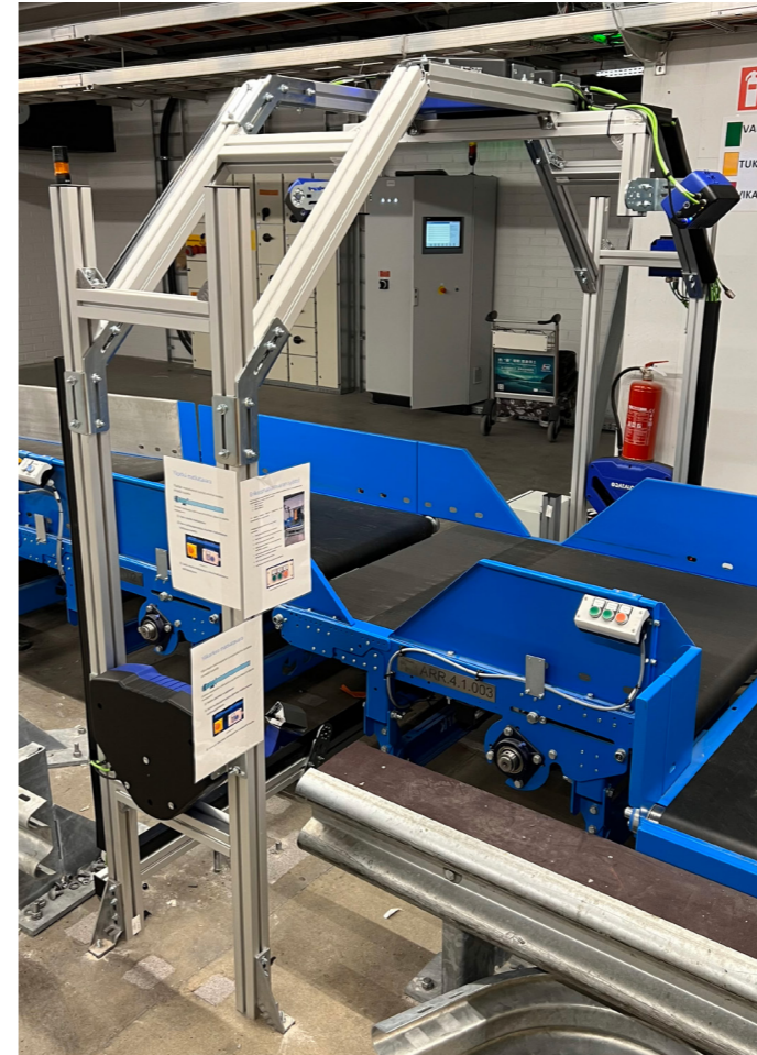
System automatyzujący odczyt etykiet na linii w sortowni bagażu Port lotniczy, Skandynawia
